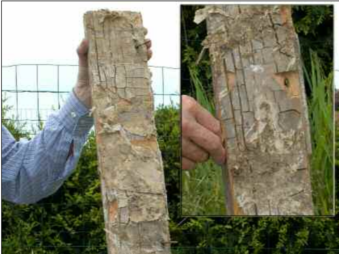
Figure 1. – Planche attaquée par la pourriture cubique (photo Protector Belgium).
