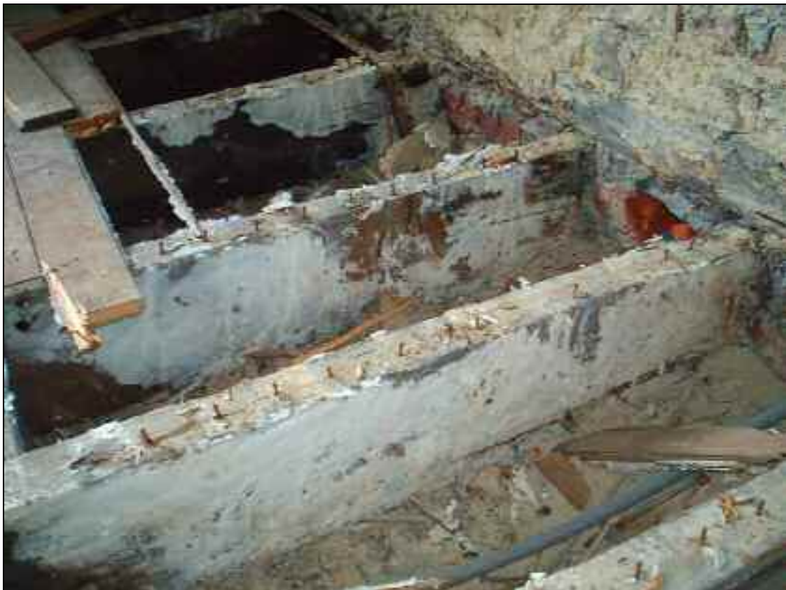
Figure 2. – Serpula lacrymans (mérule), attaque des boiseries en dessous d'un plancher (photo Protector Belgium).
